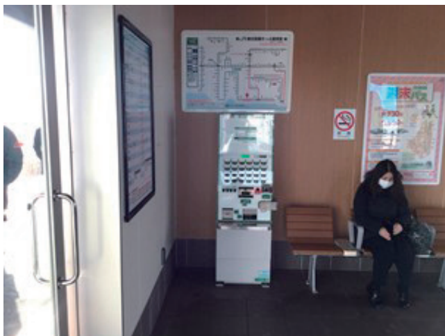
写真① 無人駅に自立露出にて設置された券売機
